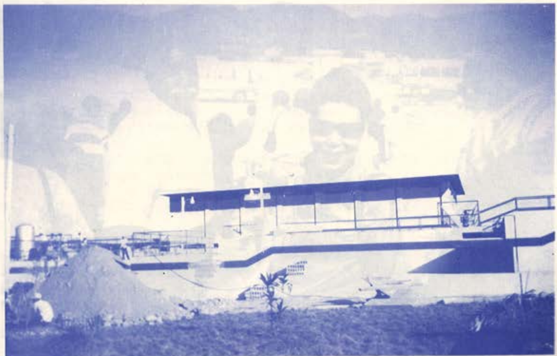
Moca, Tierra Dura. Planta de Tratamiento, observan los Sres. David Martí, su esposa Ulivis de Fase final de la planta de tratamiento de Tierra Dura, Moca. Con capacidad de tres módulos de 500 litros c/u por segundo.
